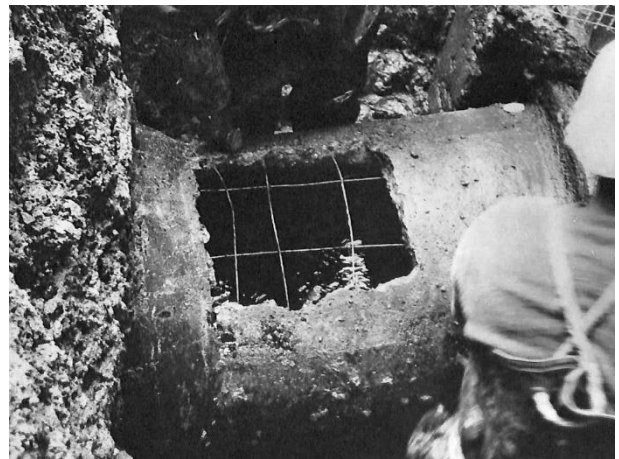
十勝沖地震 * による導水管 * の破損
