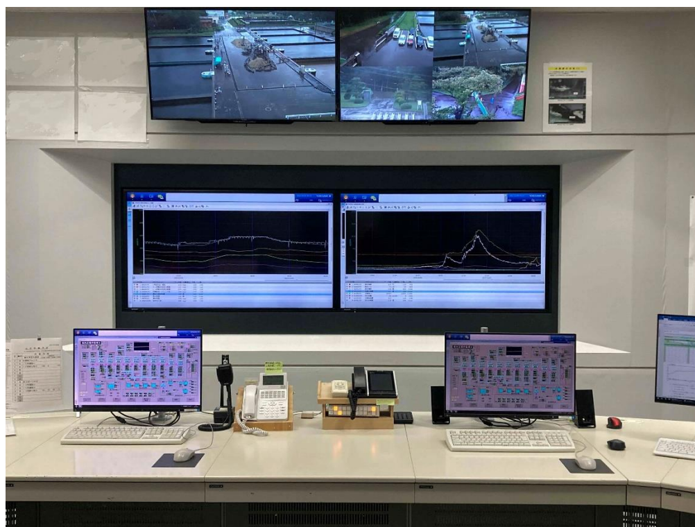
横内浄水場中央制御室
