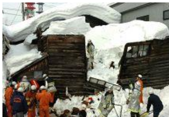
図 46 雪の重みで倒壊した家屋
