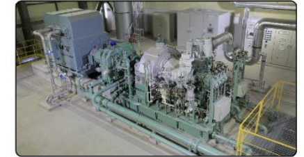
蒸気タービン発電機
