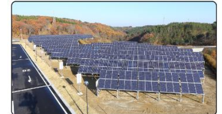
太陽光パネル
