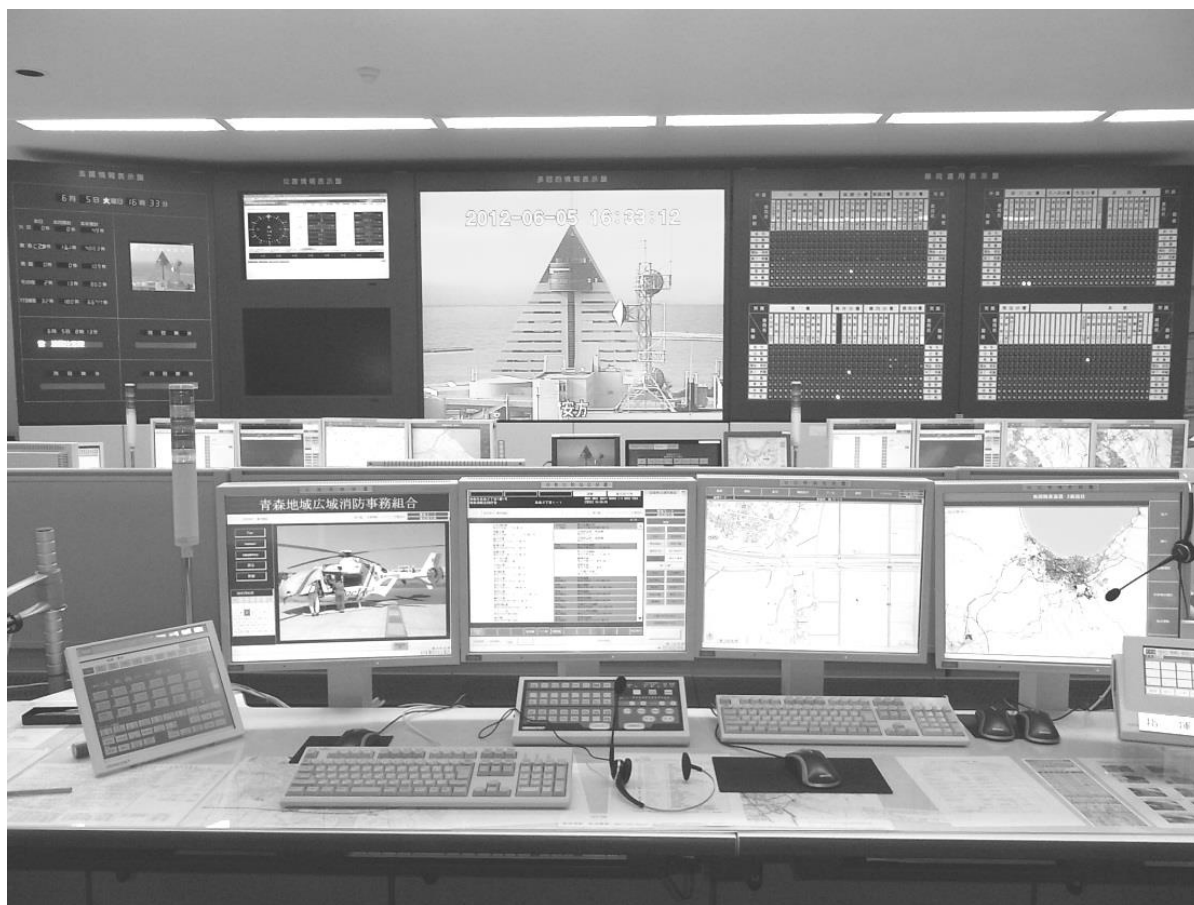
高機能消防指令システム
