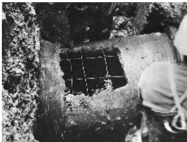
十勝沖地震 * による導水管 * の破損
