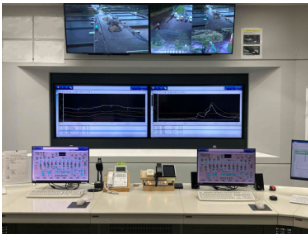
横内浄水場中央制御室
