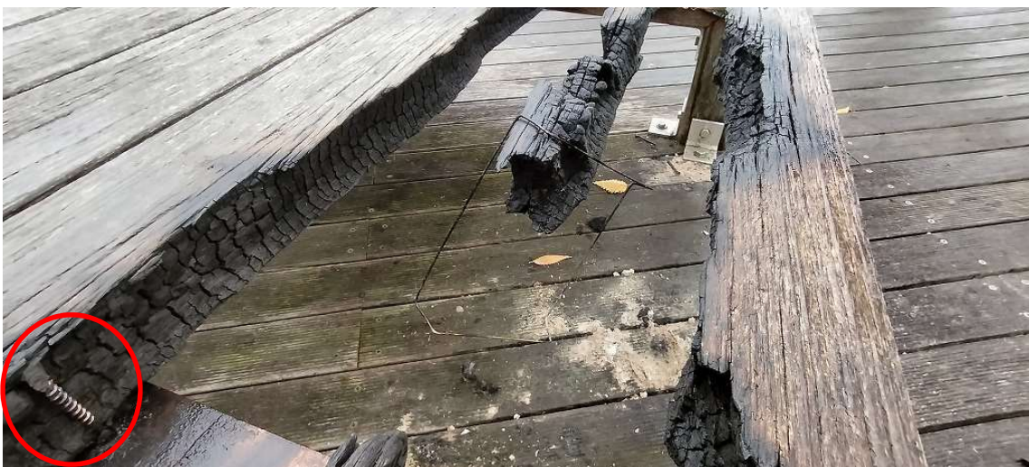
(○箇所 天板焼損により露出した木ねじ)
