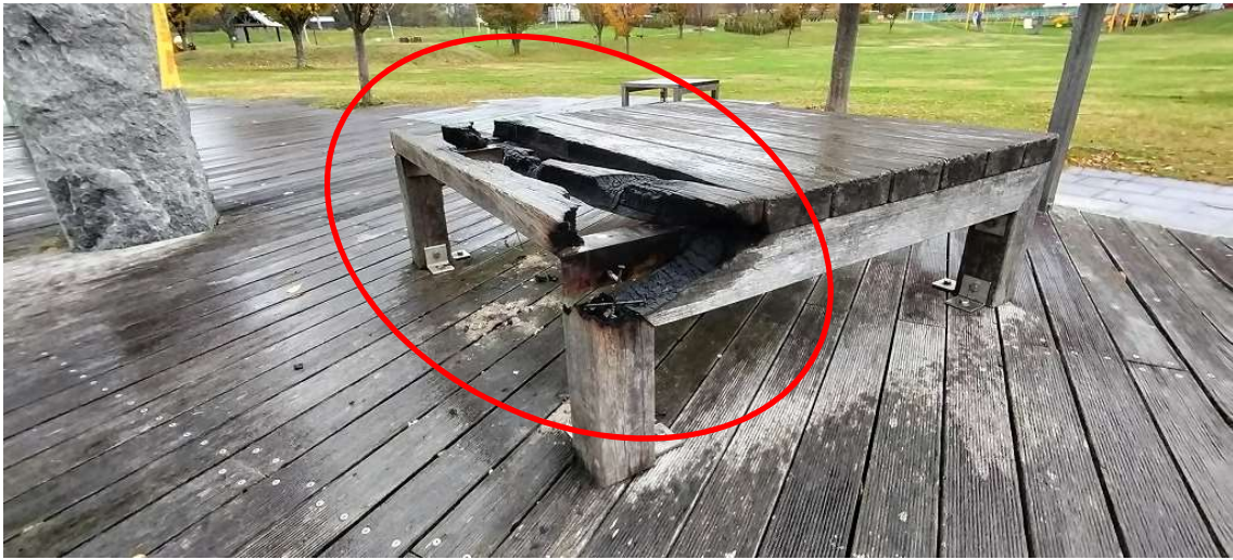
(○箇所 木製テーブル焼損箇所 約40cm×約1.2m)
