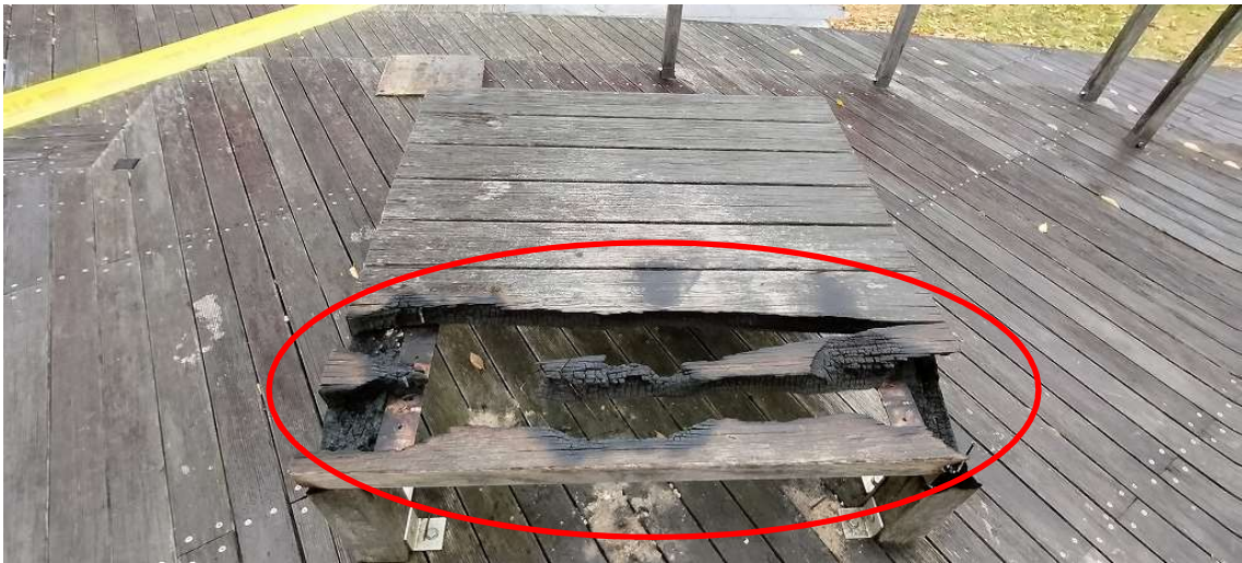
(○箇所 木製テーブル焼損箇所)
