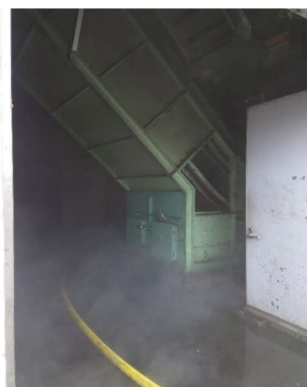
破砕機室内煙発生
