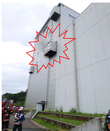
排気ダクトより黒煙
