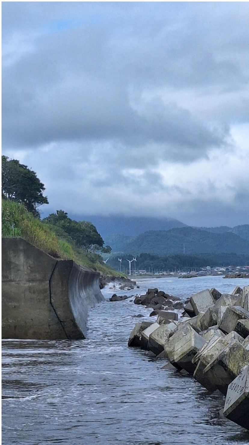
【既設消波ブロック水没】
