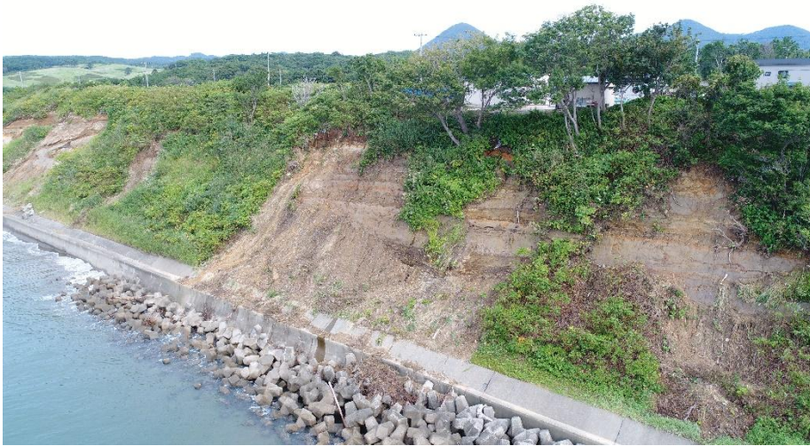
【法面崩落箇所】
