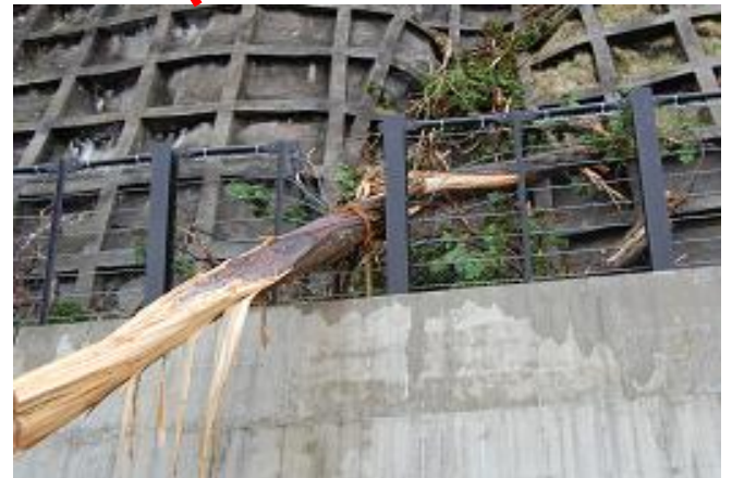
※暴風による倒木被害写真
