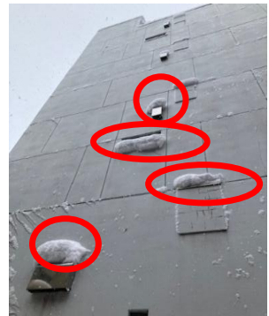
東側壁面の積雪
