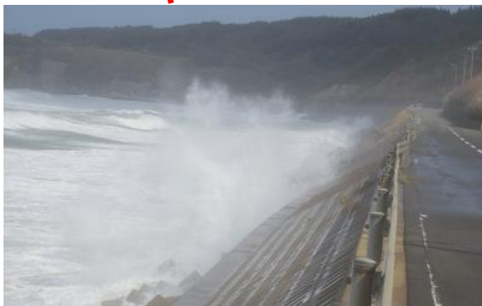
※高波による交通障害写真
