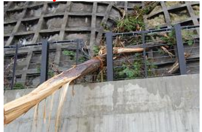
※暴風による倒木被害写真
