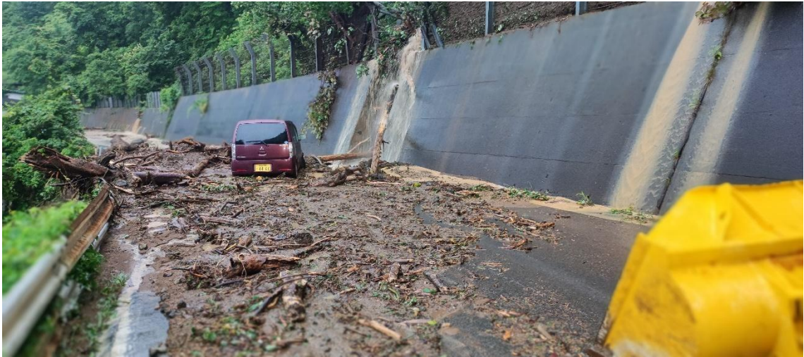
※令和4年度 8月大雨被害
