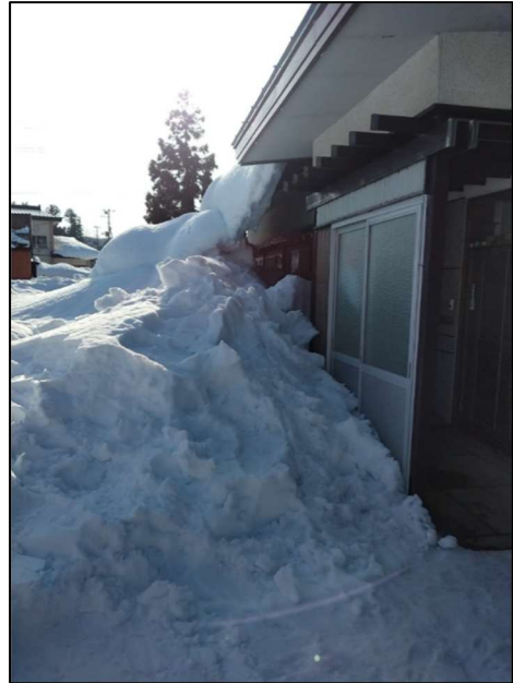
落雪した屋根雪による間口閉塞（R7）
