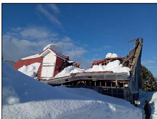
屋根雪により全壊した牛舎（R6）
