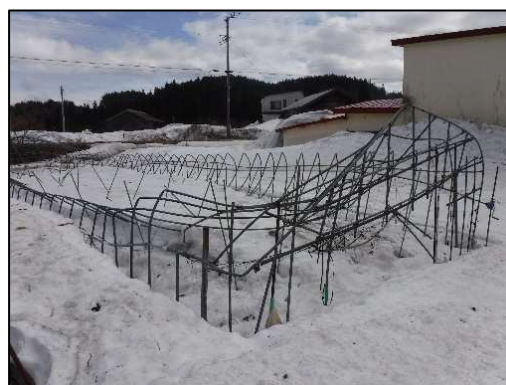
損壊したパイプハウス（R6）
