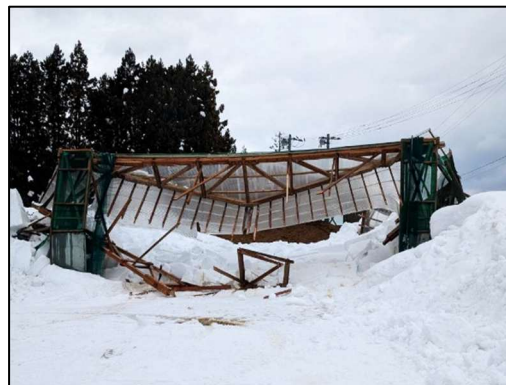
屋根雪により全壊した堆肥舎（R7）
