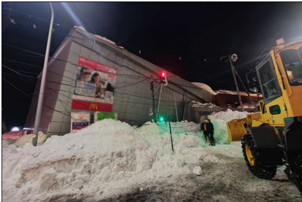
商業施設の屋根雪の道路への落雪（R7）
