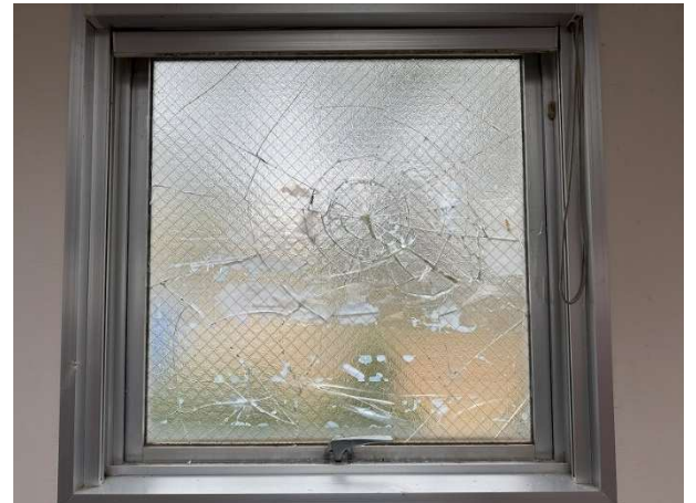
(破損状況近景)
