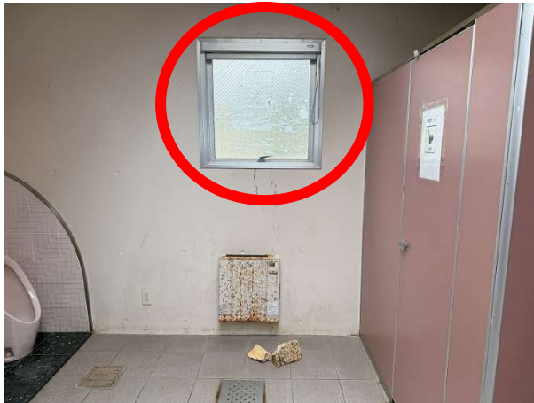
(破損状況全景)
