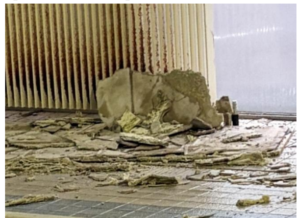
【落下した天井材】
