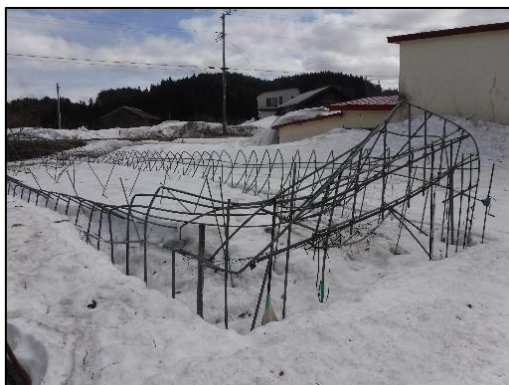
損壊したパイプハウス
