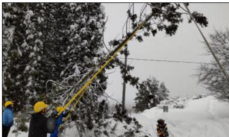
雪による倒木の撤去作業
