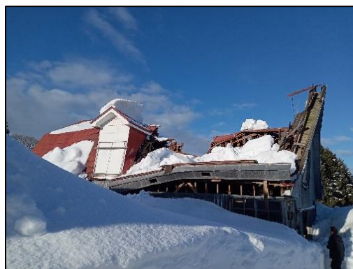
屋根雪により全壊した牛舎
