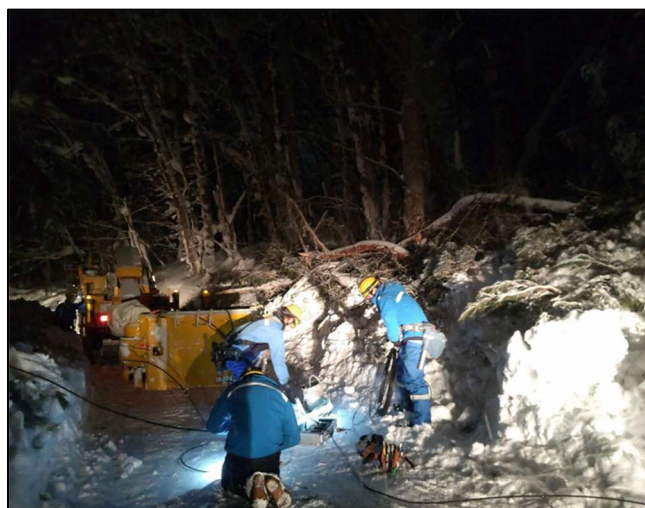
高圧線への倒木除去（R7）
