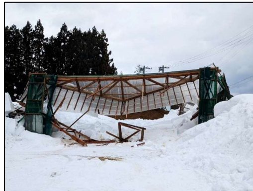
屋根雪により全壊した堆肥舎（R7）
