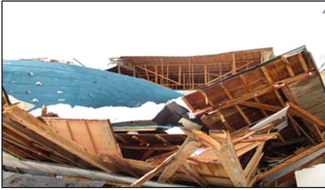
屋根雪により全壊した浪岡中央児童館（R6）
