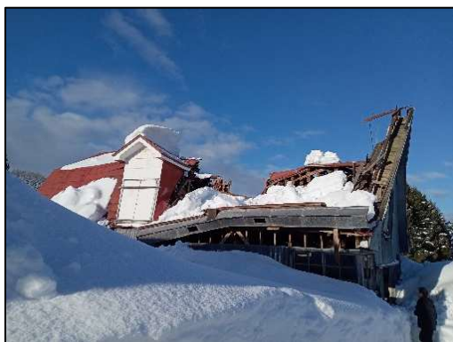
屋根雪により全壊した牛舎（R6）
