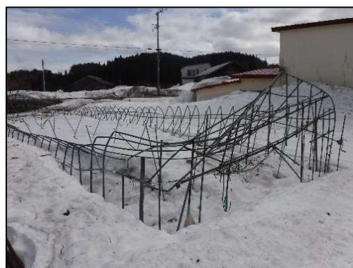
損壊したパイプハウス（R6）
