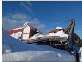
屋根雪により全壊した牛舎
