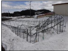
損壊したパイプハウス
