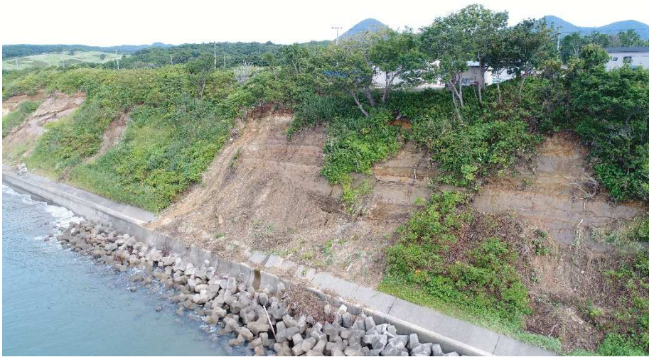
【法面崩落箇所】
