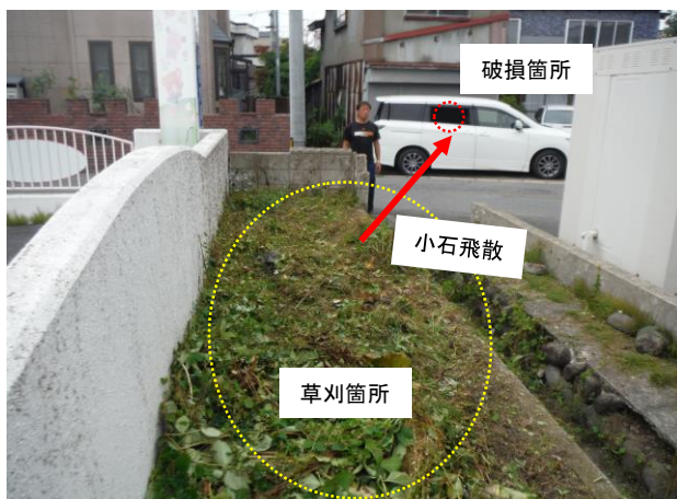
発生箇所全景
