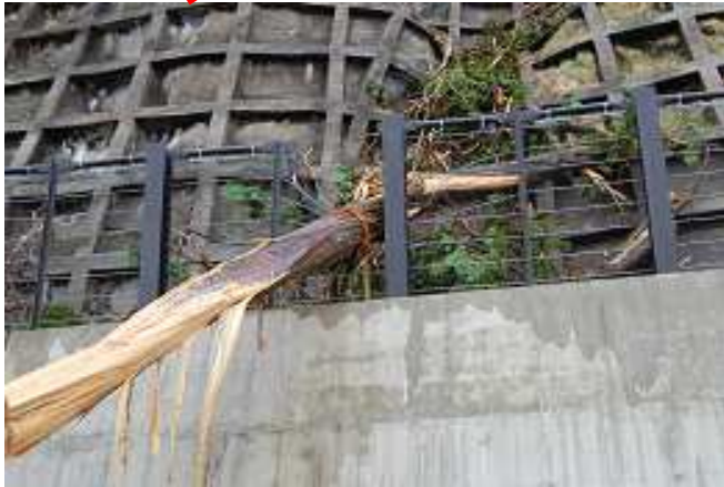
※暴風による倒木被害写真
