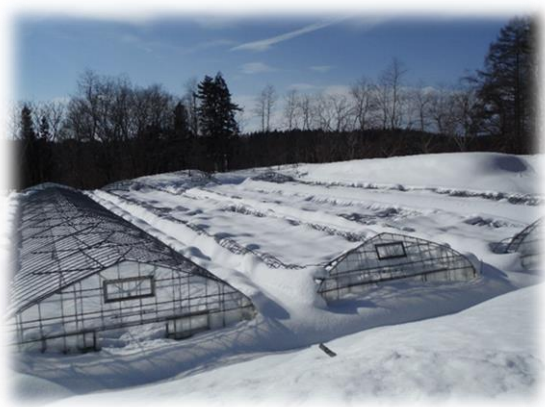
雪の重みで倒壊したパイプハウス
