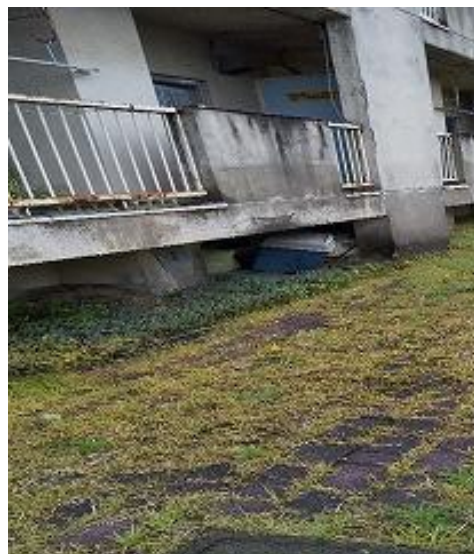
【写真 床下スペースに放置された私物】
