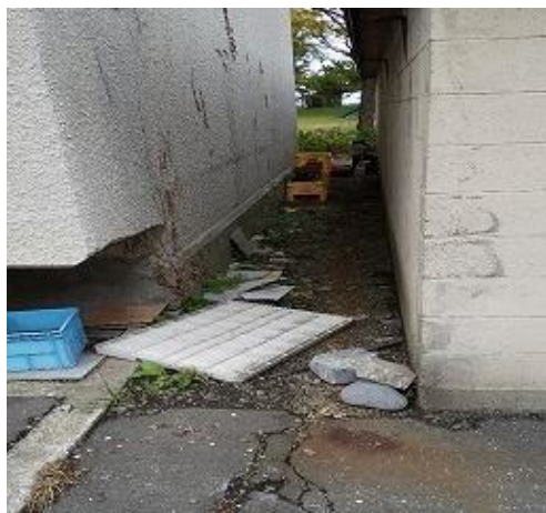
【写真 建物間に放置された廃棄物】
