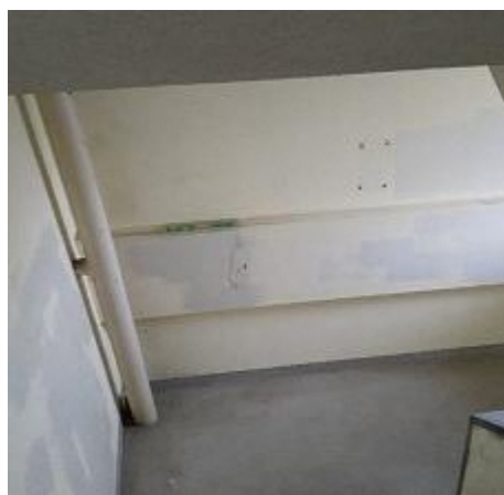
【写真 階段スペースの剥がれ落ちた表示板】
