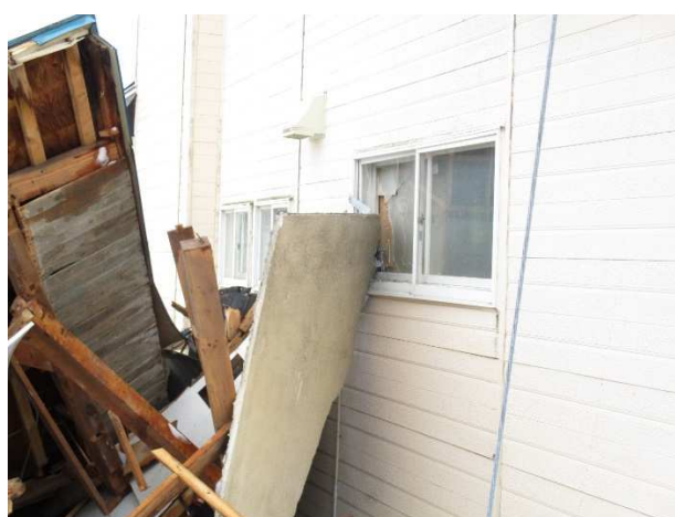
⑤隣家住宅への被害
