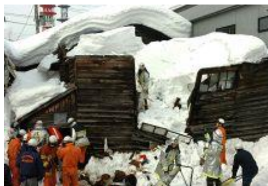
図 81 雪の重みで倒壊した家屋
