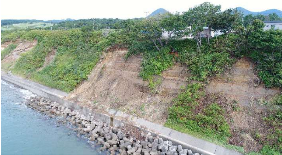
【法面崩落箇所】
