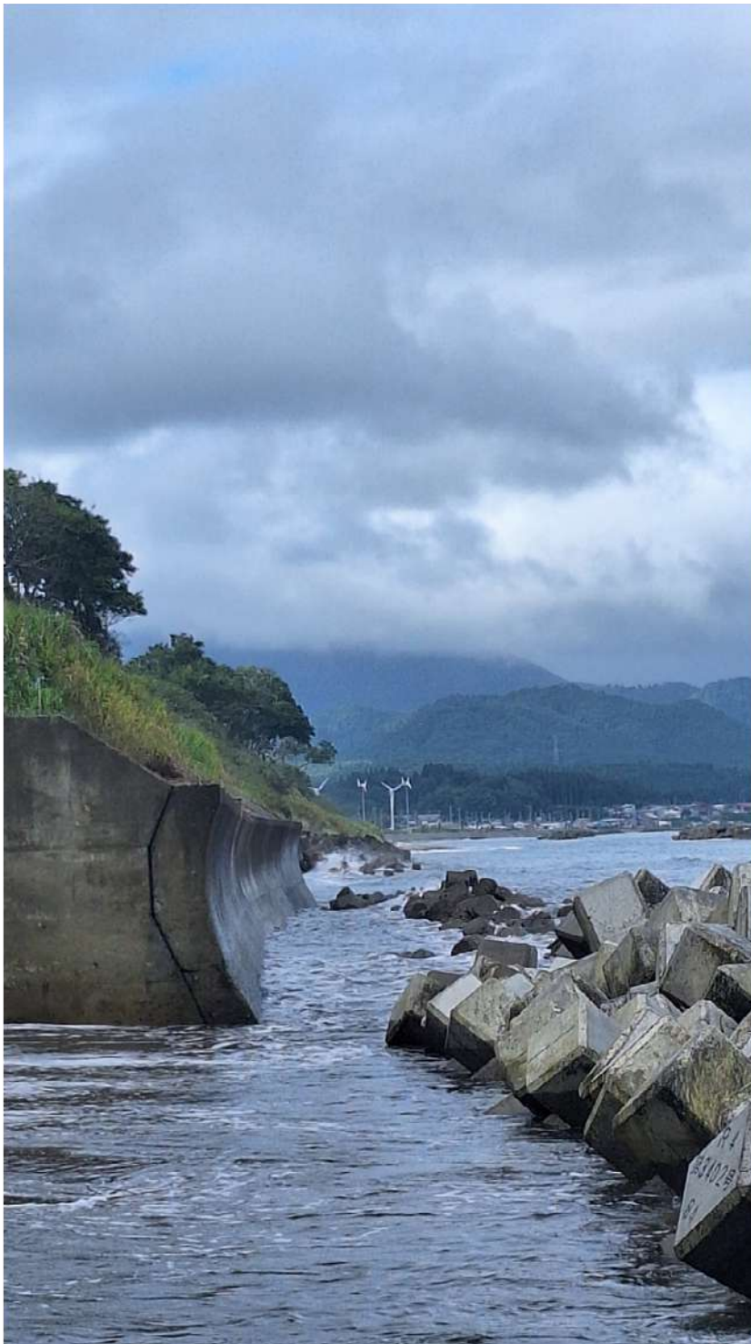
【既設消波ブロック水没】
