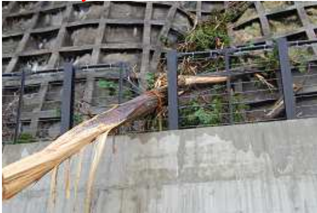
※暴風による倒木被害写真
