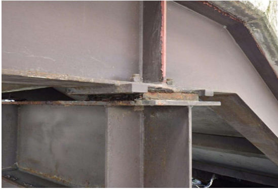
あすなろ橋(支承部の腐食)
