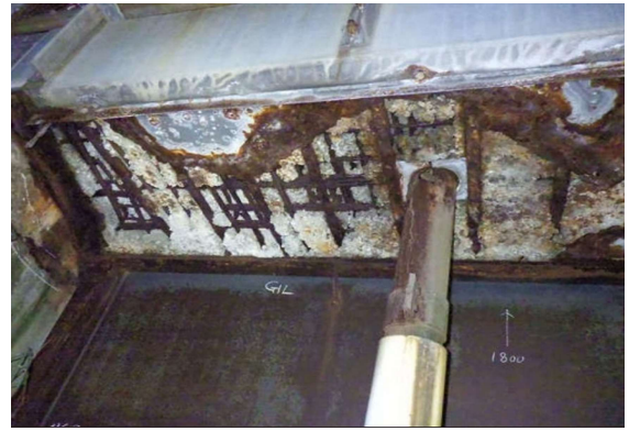
山本橋(床版の損傷)
