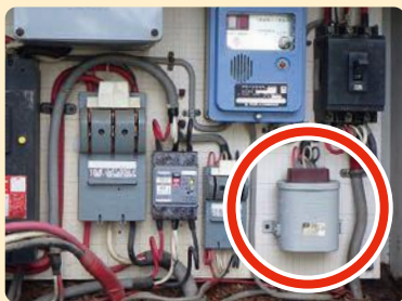
低圧分電盤内の 低圧コンデンサー
