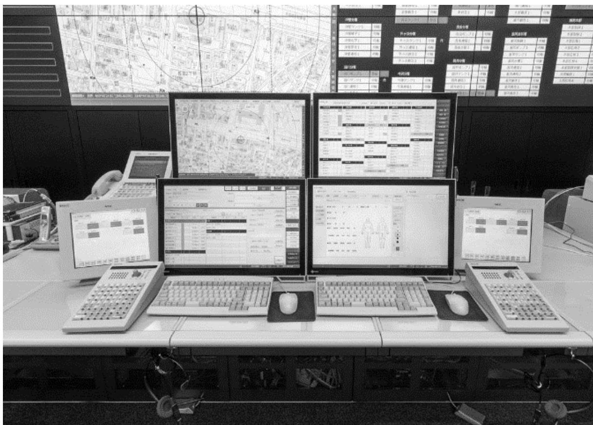
高機能消防指令システム
