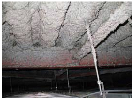
※天井内部に使用されている例
