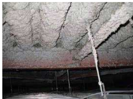
※天井内部に使用されている例
