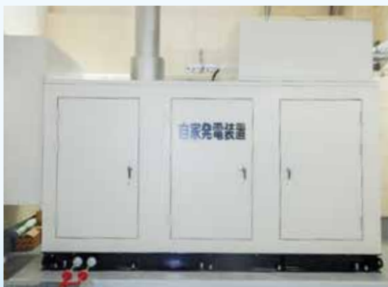
受変電設備（非常用発電機など）
