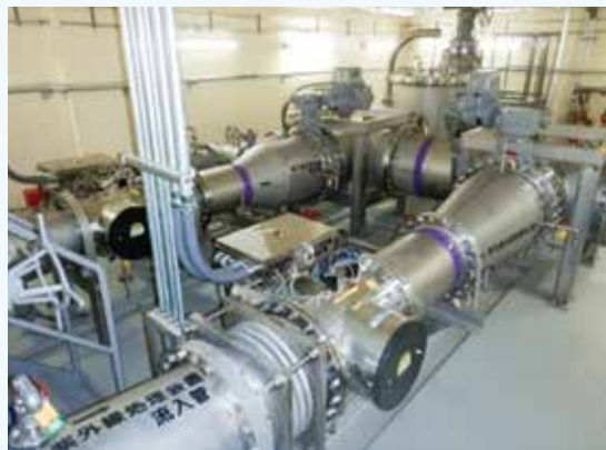
紫外線処理設備
