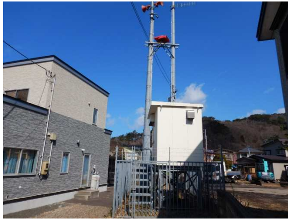
▲浅虫ダム银杏橋水位警報局
