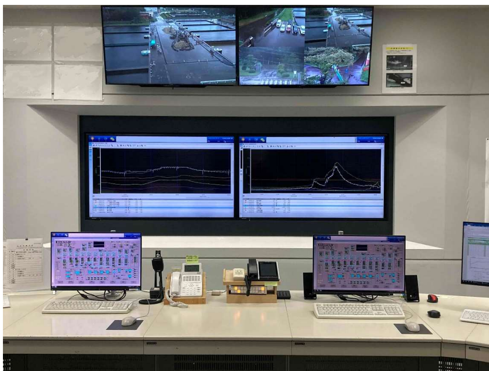
横内浄水場中央制御室
