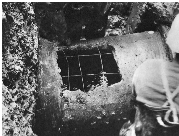
十勝沖地震 * による導水管 * の破損
